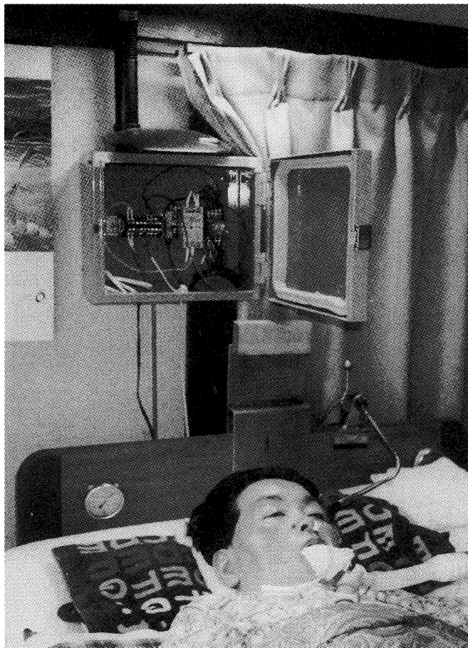
ターミナルボックスの扉を開いたアンプユニット関係
